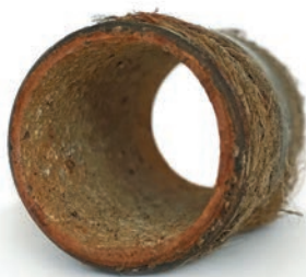
Senza protezione, tubo di riscaldamento arrugginito con depositi di magnetite
